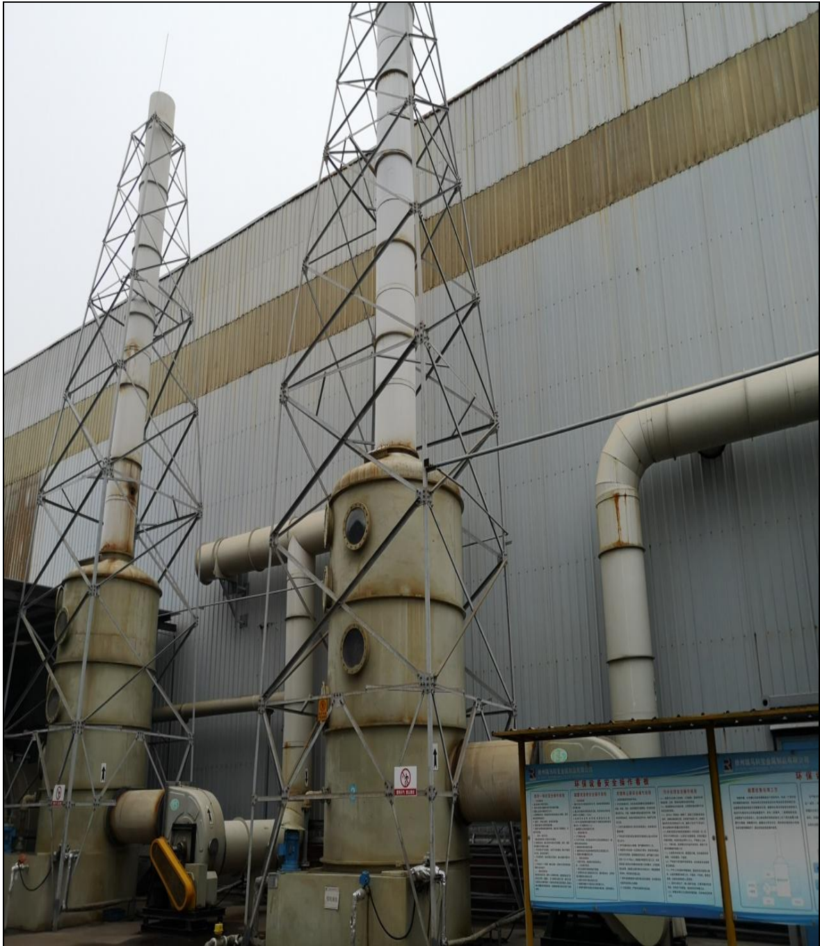
一车间酸雾喷淋塔及排气筒
