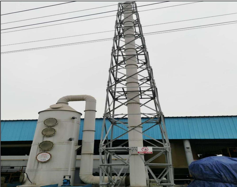
危废库废气处理设施
