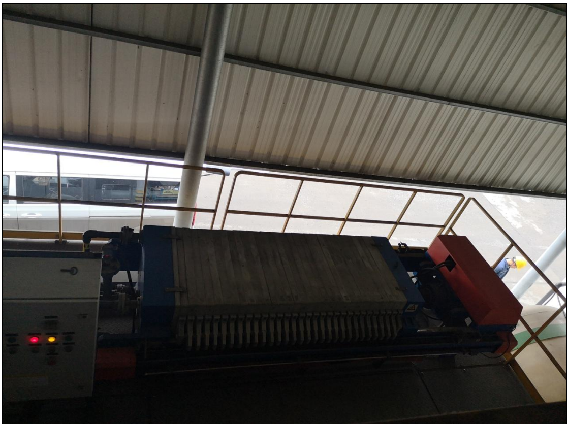
三车间废水处理装置
