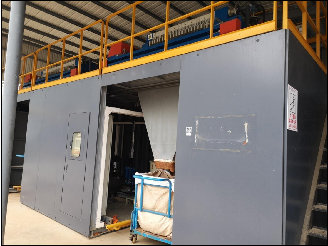
一车间废水处理装置
