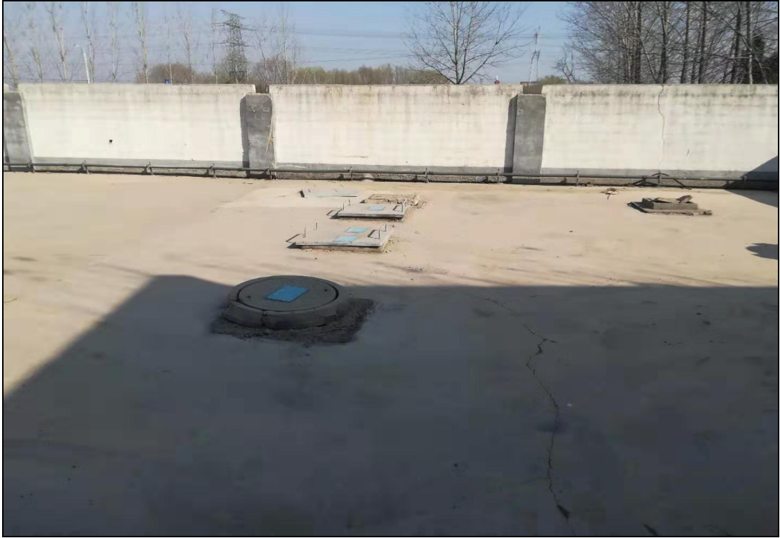
生活污水处理设施
