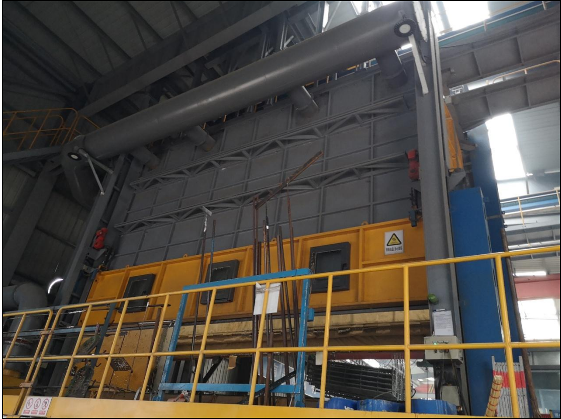
四车间锌锅收集设施
