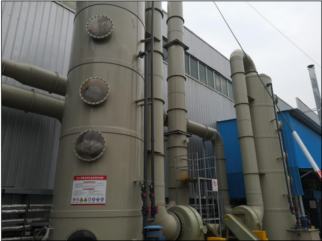
四车间酸雾吸收塔
