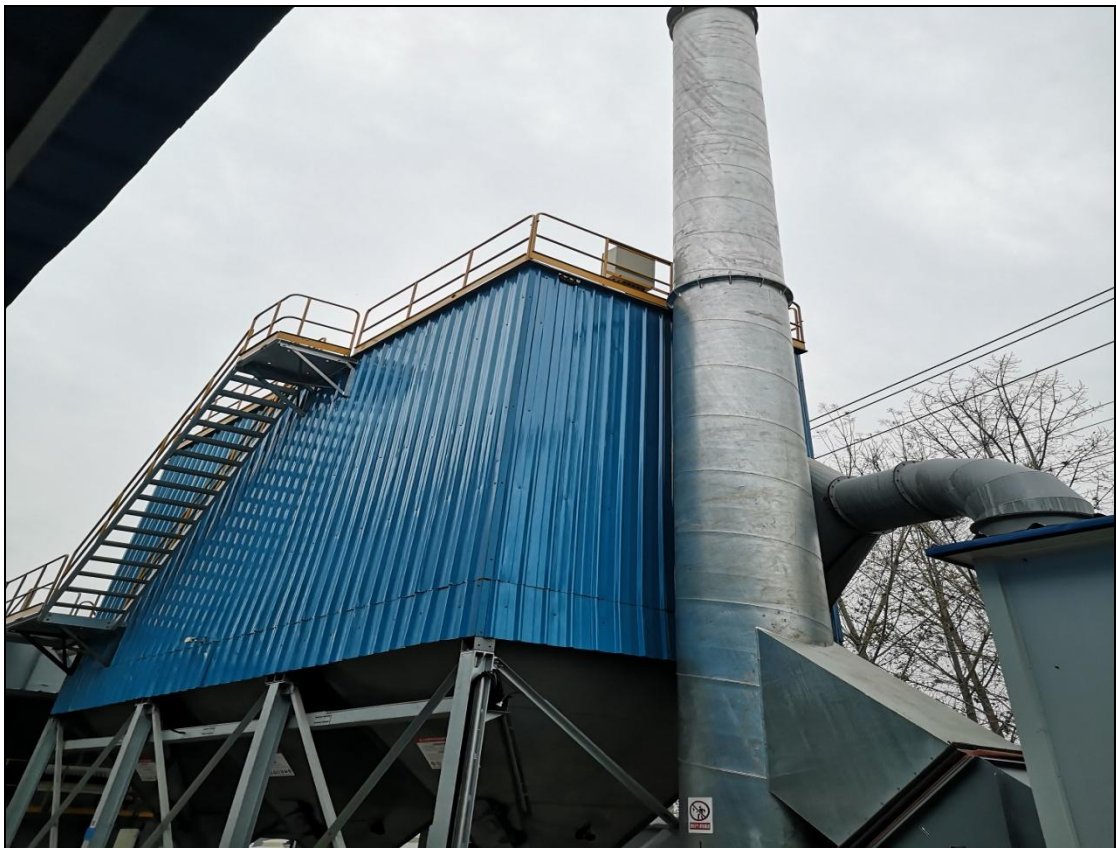
四车间热镀锌锌烟布袋除尘器及排气筒
