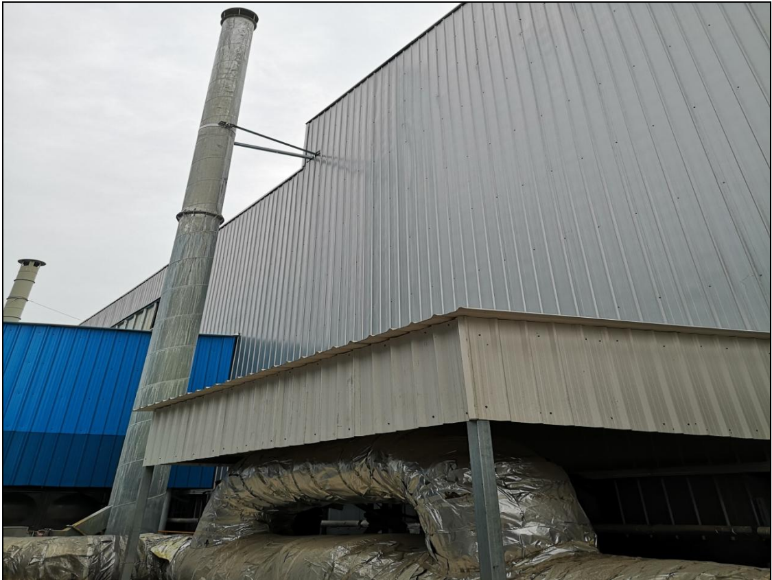
四车间天然气燃烧废气排气筒
