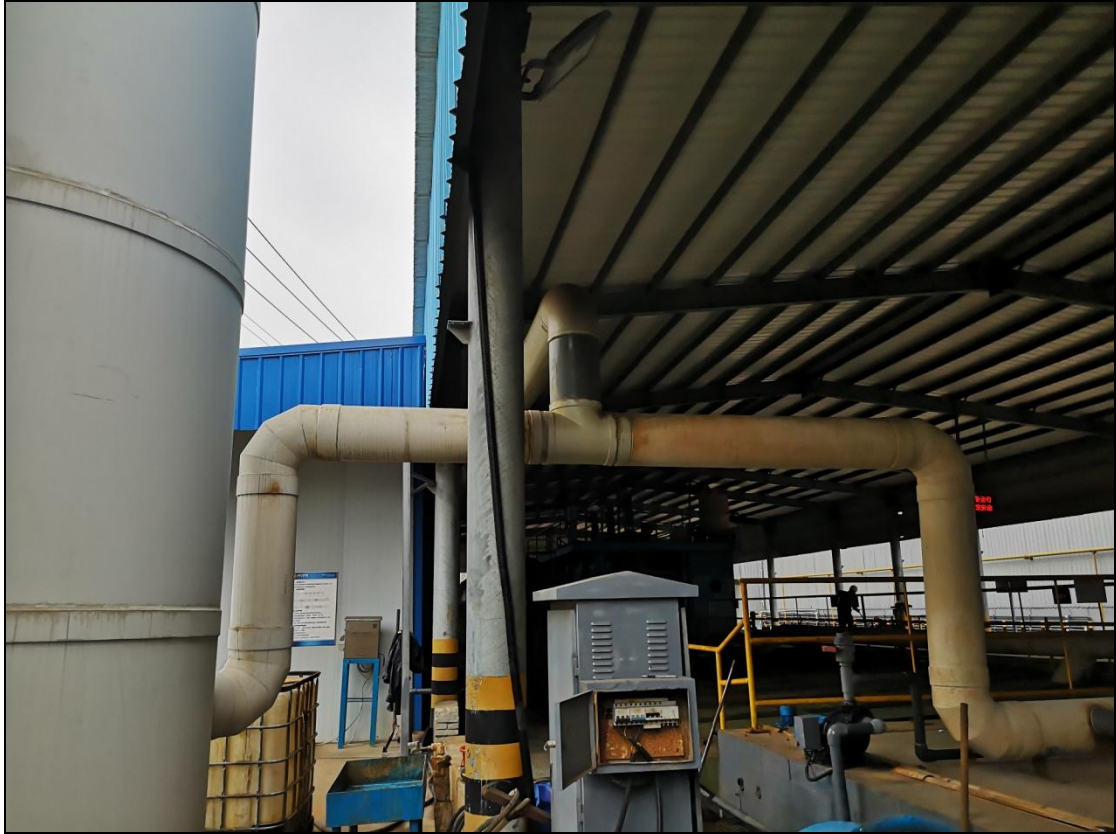
絮凝剂生产线收集管道
