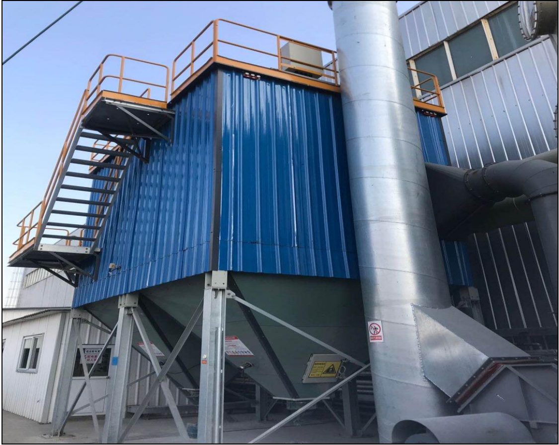
四车间热镀锌锌烟布袋除尘器及排气筒（1.6万吨生产线）
