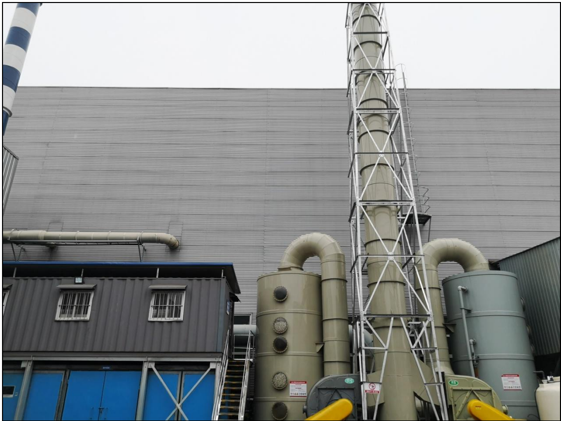
三车间酸雾吸收塔及排气筒
