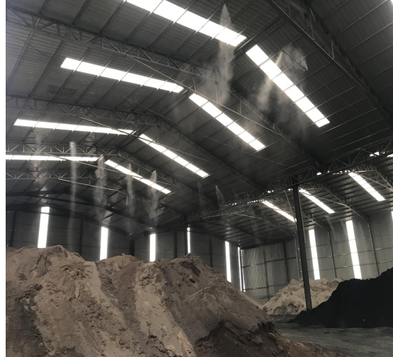
原料大棚喷淋设施
