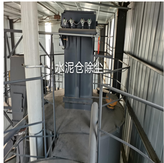
1#、2#水泥仓脉冲布袋除尘器
