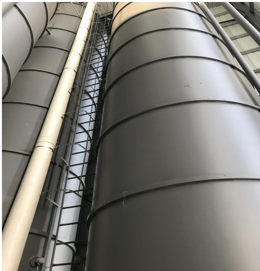
散装机排气筒
