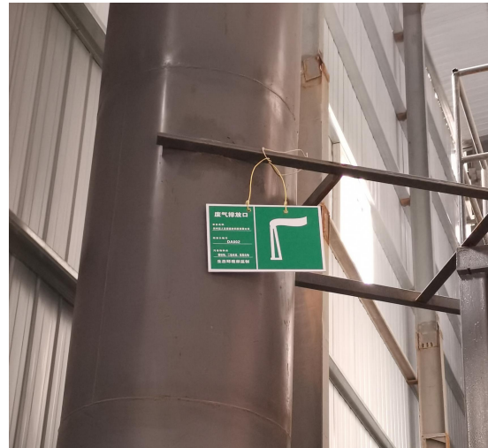
生物质烘干机排气筒标识牌
