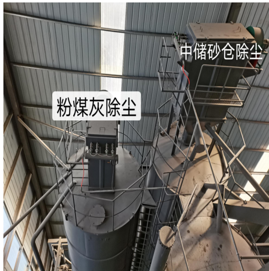
粉煤灰筒仓、中储砂仓脉冲布袋除尘器
