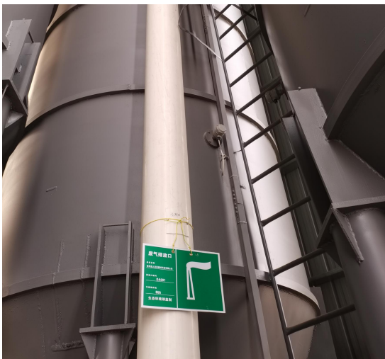
散装机排气筒标识牌
