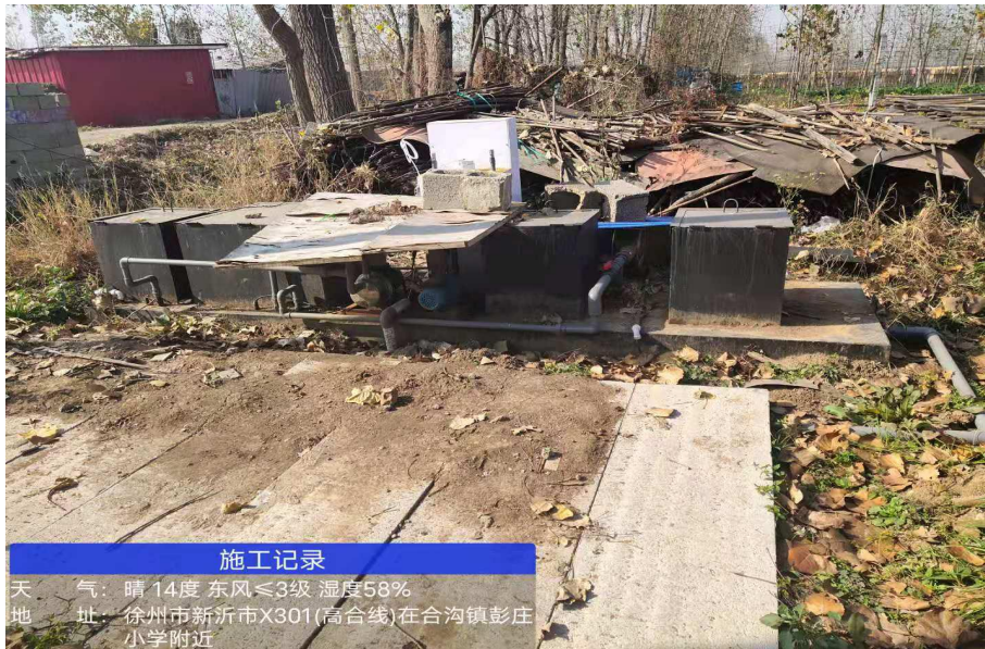
地埋式污水处理设施
