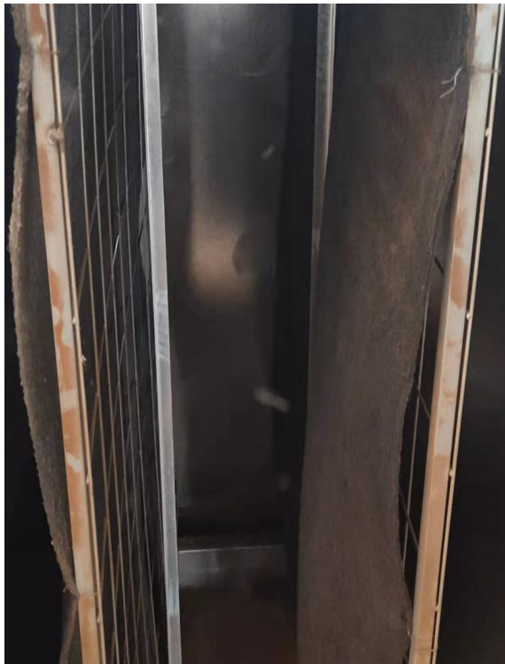
光氧箱过滤棉预处理
