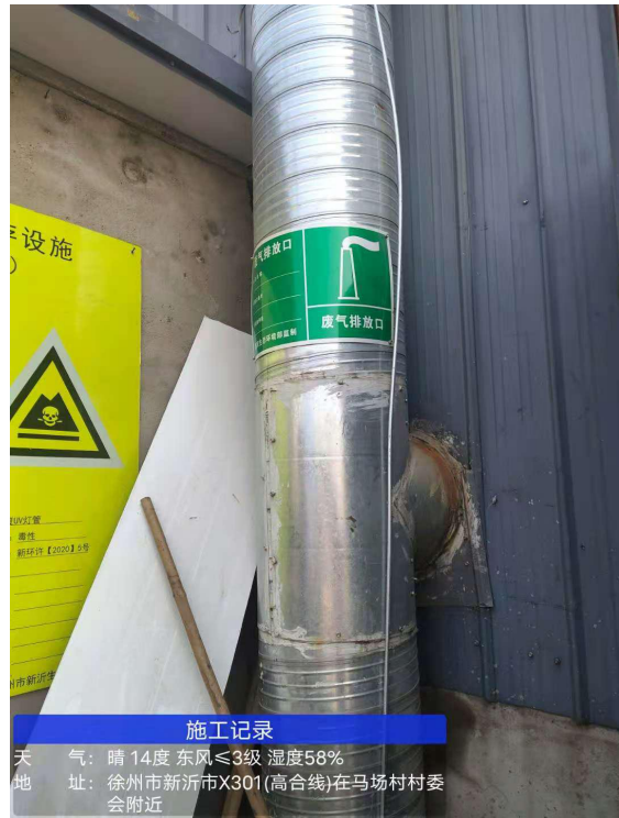
有机废气排放口标识牌
