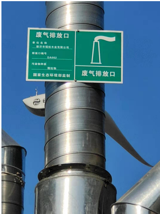
切断废气排放口标识牌
