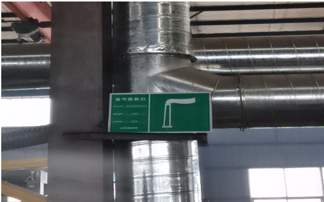
排气筒及标识牌
