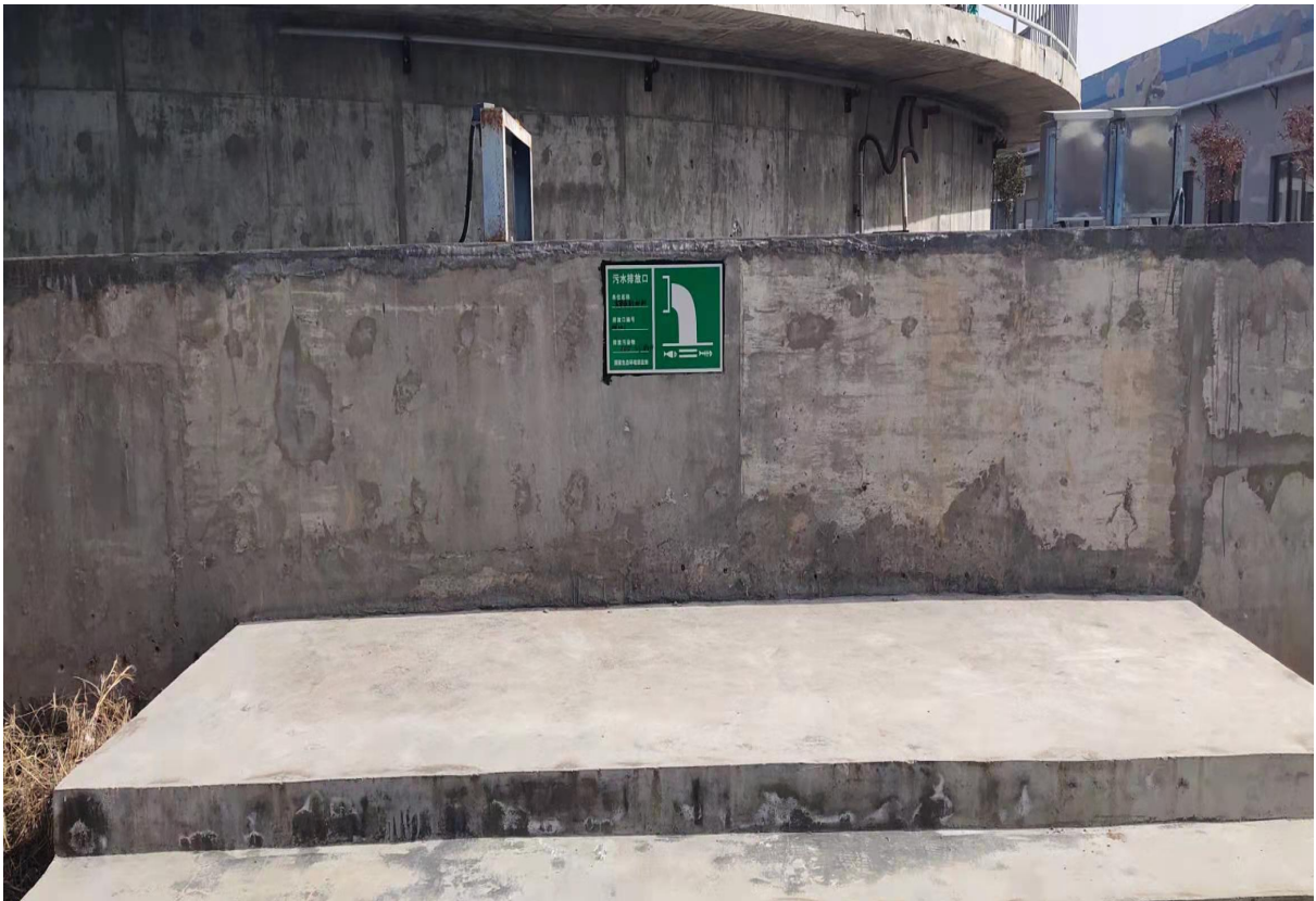
污水排放口标识牌
