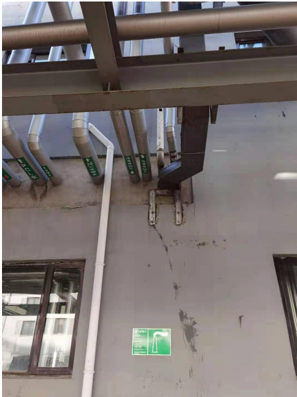
蒸发浓缩排气口
