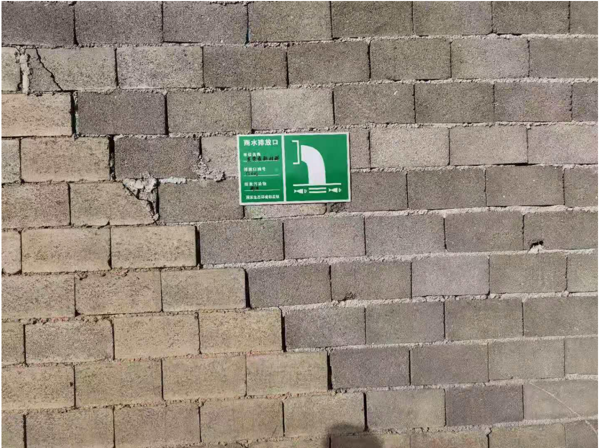
雨水排放口标识牌
