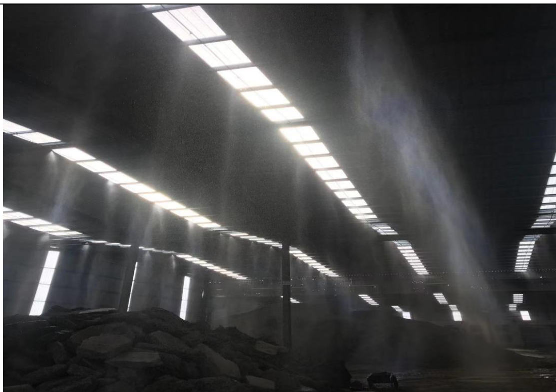
图 3.2-5 生产车间上方喷淋设施
