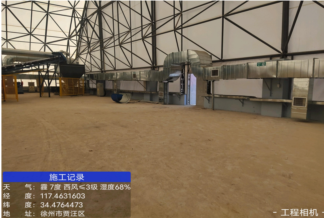
库内废气管道收集系统
