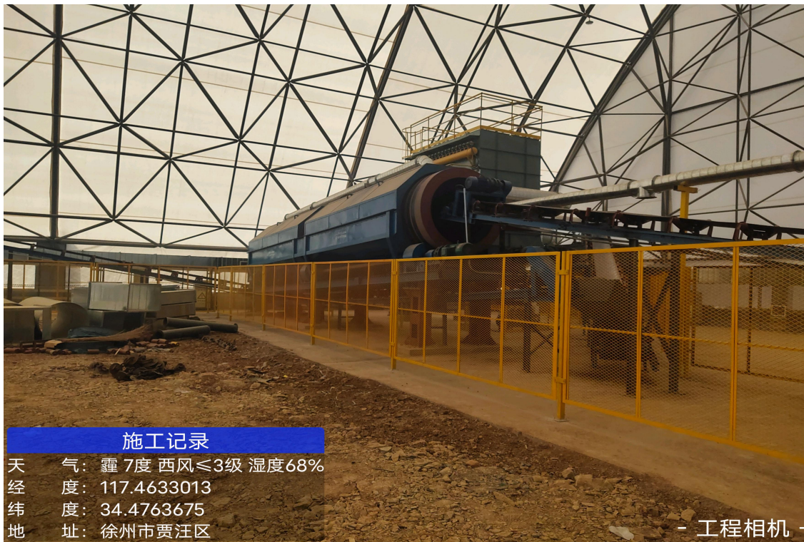
滚筒筛收尘管道
