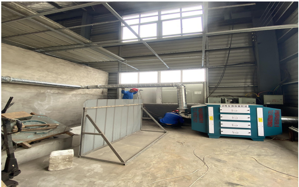
图 3.2-10 浸涂料烘干工序活性炭吸附装置
