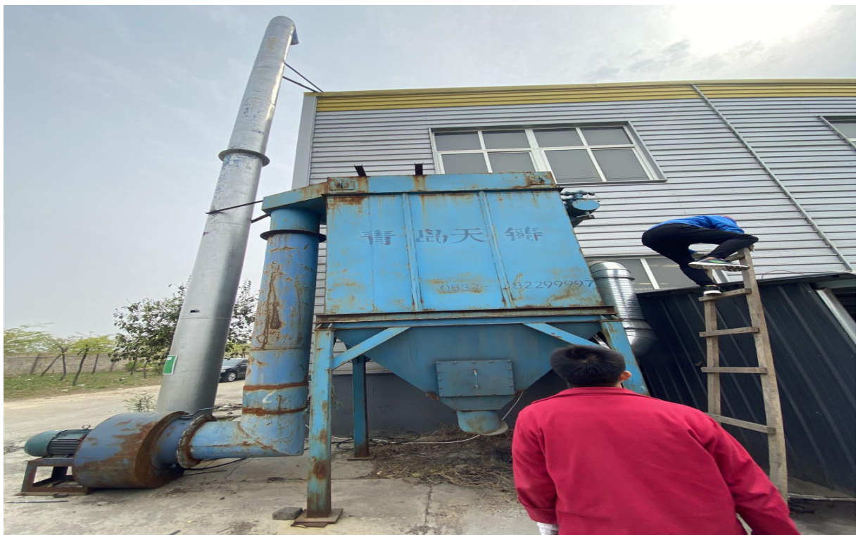
图 3.2-8 打磨工序脉冲式布袋除尘器及排气筒
