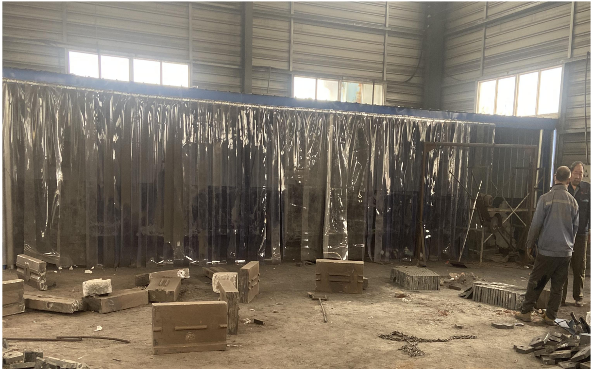
图 3.2-7 打磨工序封闭式打磨房
