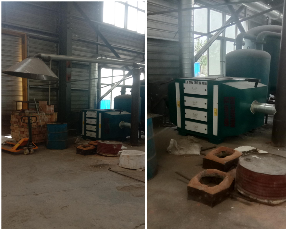
图 3.2-12 浇注工序集气罩及活性炭装置
