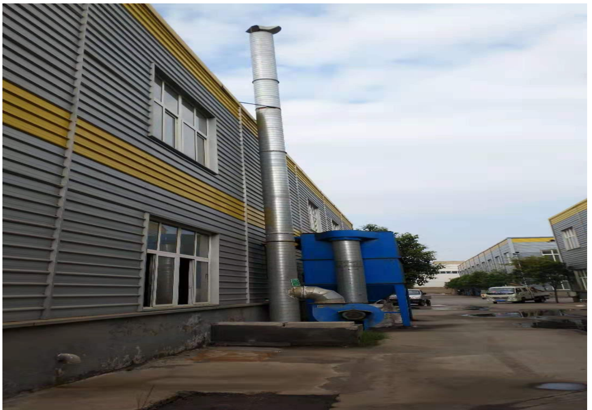
图 3.2-6 砂处理工序脉冲式布袋除尘器及排气筒
