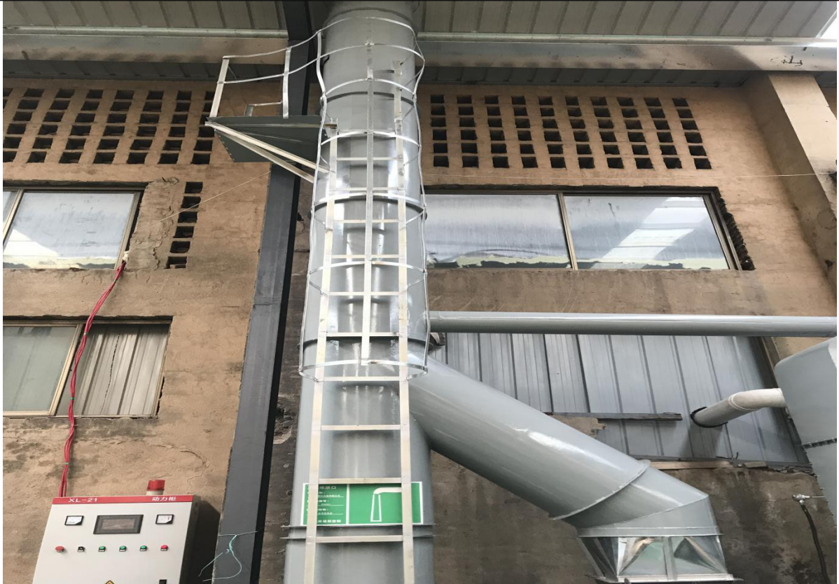
图 3.2-4 废气排放口标识牌及监测平台
