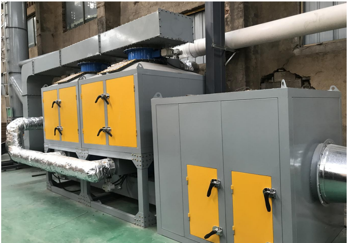
图 3.2-3 废气处理设施（干式过滤箱+活性炭吸/脱附+催化燃烧）
