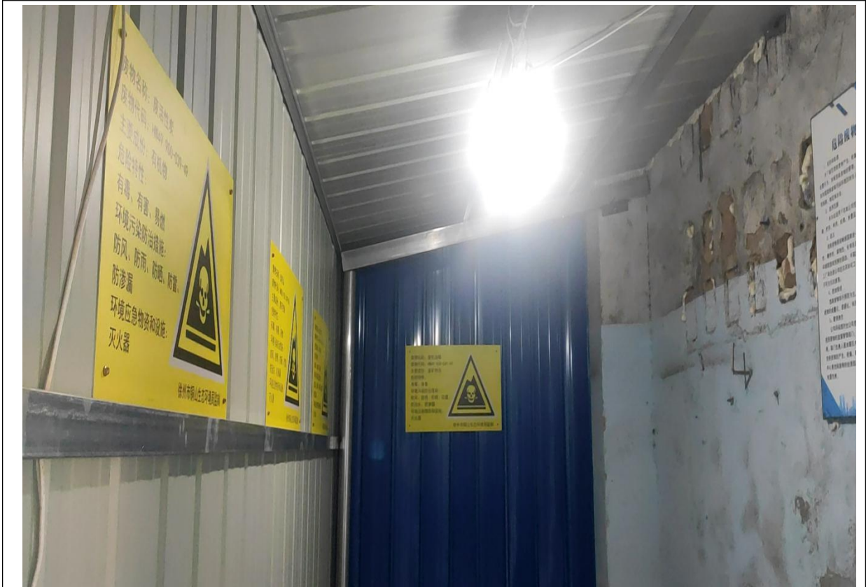
图 3.4-3 危废库分区标识牌及防爆灯
