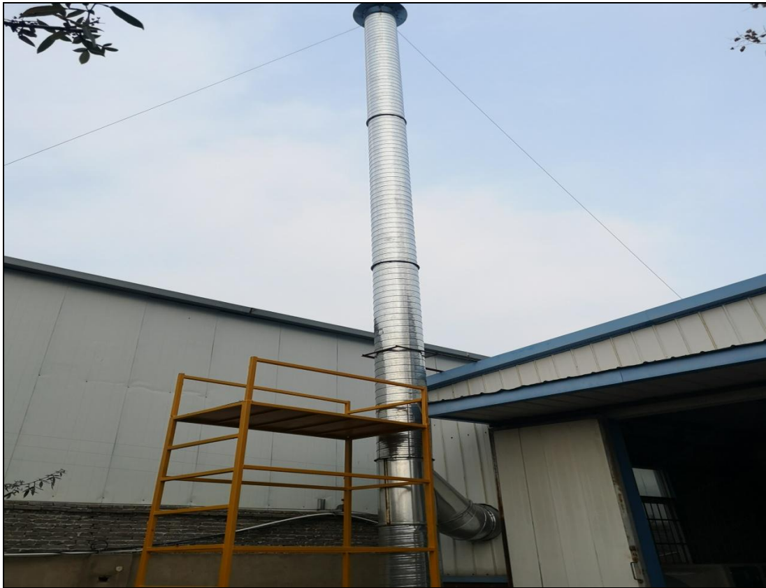
模组（自动线）废气处理设施及排气筒
