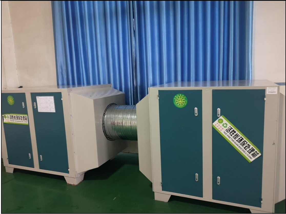
控制器生产线废气处理设施
