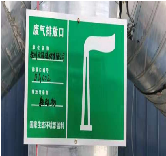
打磨、砂光废气排气筒标识牌
