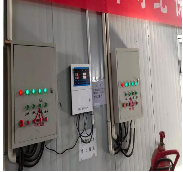
人工补漆间气体报警装置
