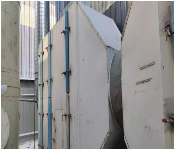
干式过滤箱+活性炭箱 (人工补漆间废气处理设施)
