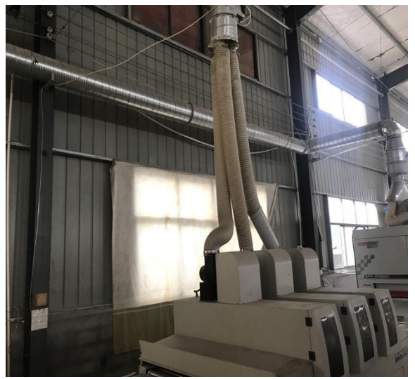
有机废气收集系统
