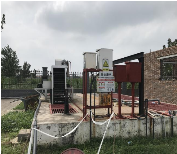
粗格栅+进水泵房
