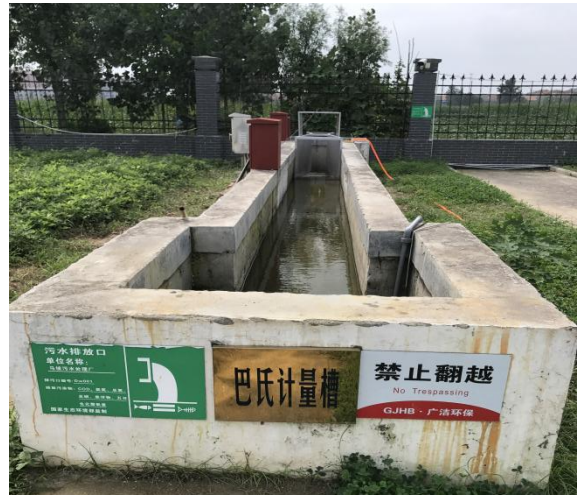
巴氏计量槽+污水排放口
