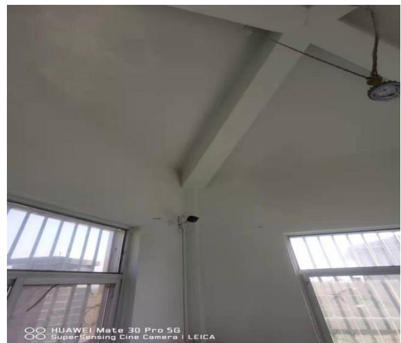
监控设施及防爆灯
