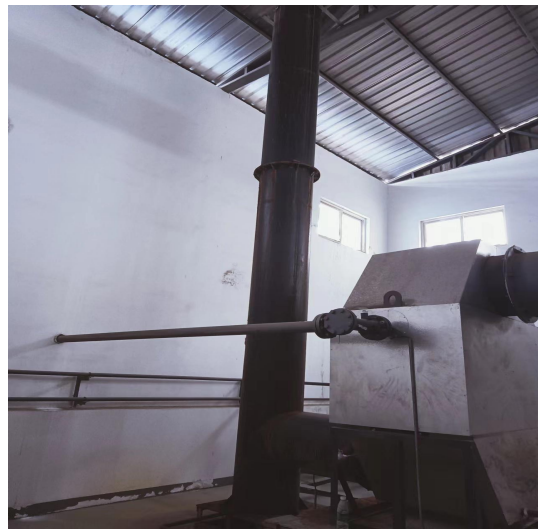
废气排气筒（15m）
